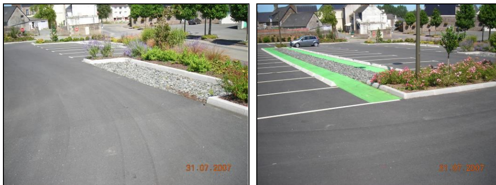
Photo 4 : Exemple de tranchées drainantes
